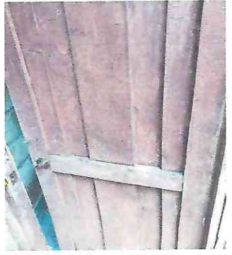
Foto 3: Puerta de servicio sanitario en mal estado.
